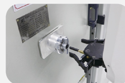
紧急分闸操作
